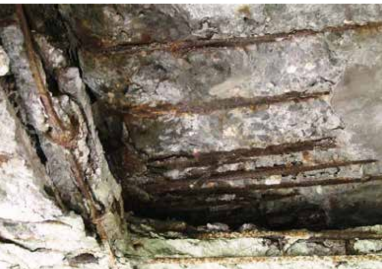
Рис. 10. Разрушение защитного слоя бетона, обрушение конструкций
