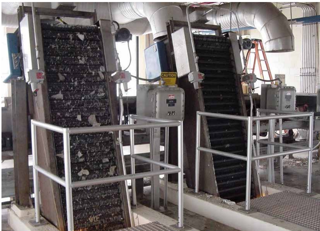
Рис. 11. Решетки с механической очисткой
