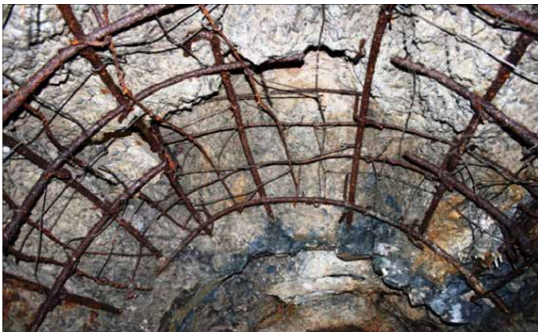
Рис. 2. Разрушение железобетона под действием влаги и иных факторов
